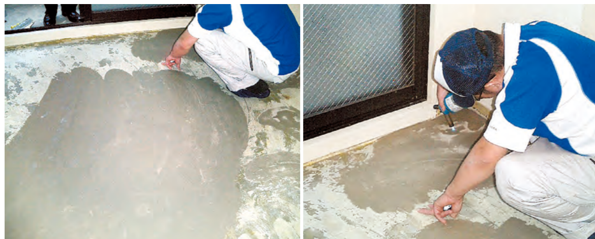
傷んでやせた下地に対して、補修作業を行わなければならない。
